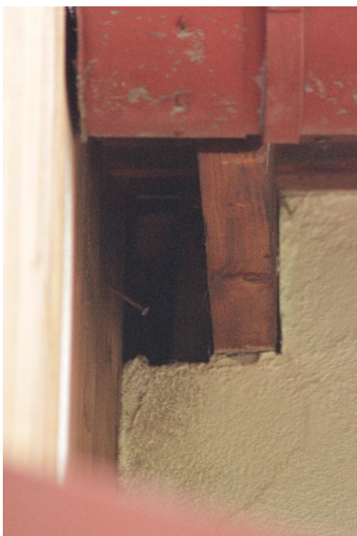
Abbildung 6: Großer Hohlraum zwischen Hauswand und Dachbalken über dem nördlichen Eingang
