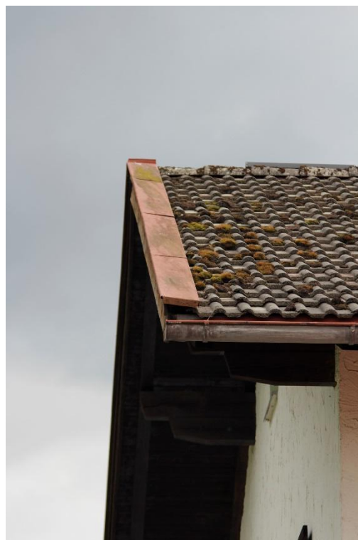
Abbildung 5: Hohlraum unterhalb der Ortgangverblechung am Nordgiebel
