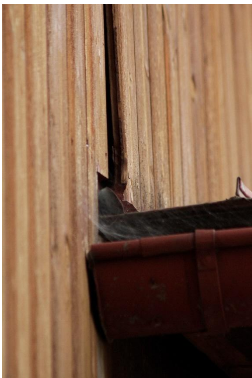
Abbildung 4: Spalte in Wandverschalung an der nördlichen Außenwand
